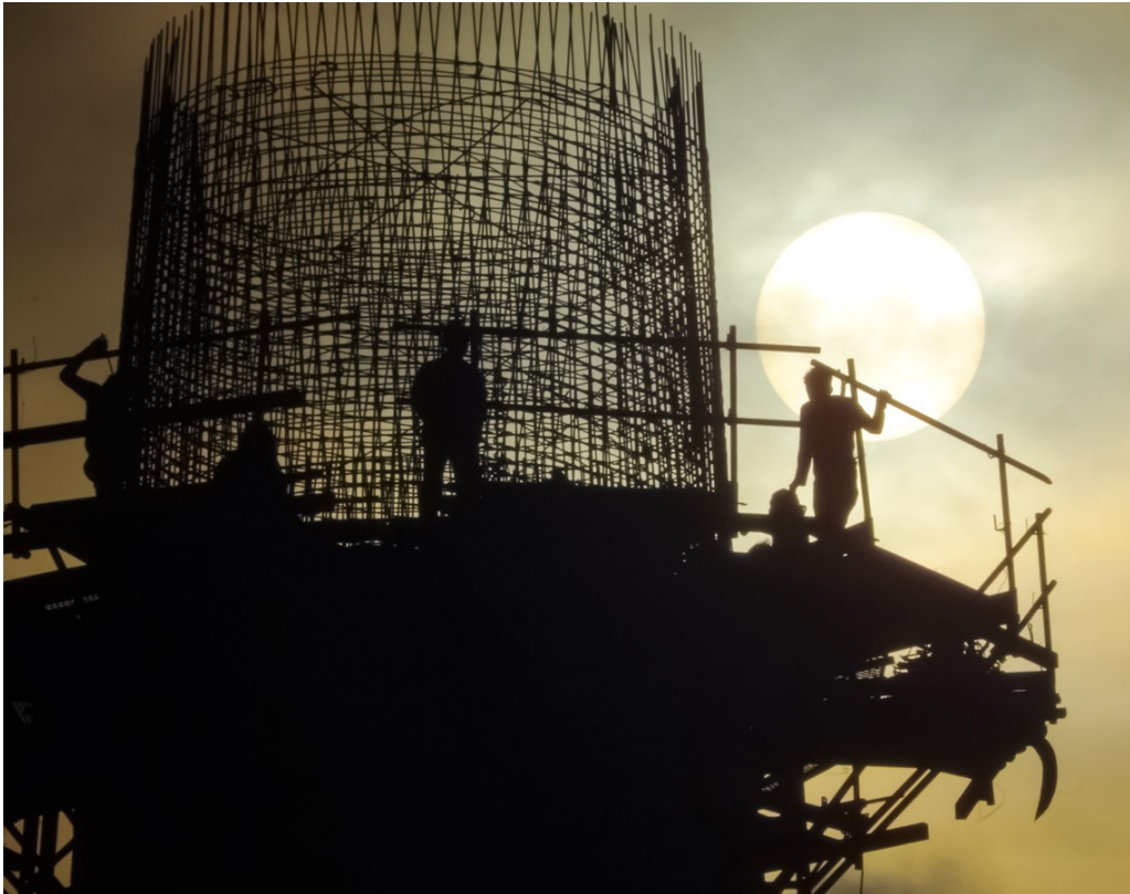
Gambar 4.3 Pekerja Kontruksi pada Pekerjaan Konstruksi Pilar Jembatan (sumber: koleksi lomba foto LPJK)
