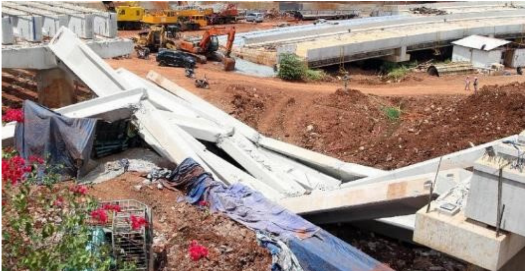
Gambar 4.11 Kecelakaan Kerja Konstruksi Proyek Pembangunan Jalan Tol Depok-Antasari (sumber: detik.com)
